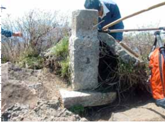
K100 三角点破損状況
