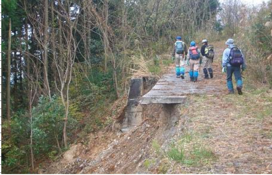
崩壊している林道(荒ヶ峠よりNo.55の鉄塔までの間)
